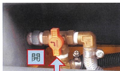
散水タンク切換コック
